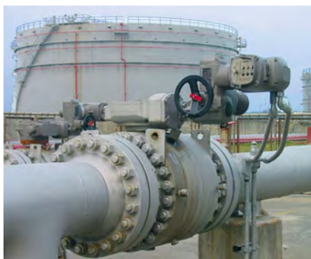
รูปที่ 6-21 Electrical Actuator ติดตั้งคู่กับ Ball Valve
