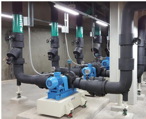
รูปที่ 9-7 Primary Chilled Water Pump
