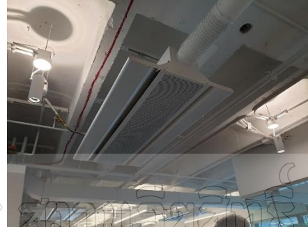
รูปที่ 9-39 การใช้ Active Chilled Beam
