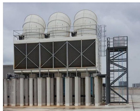
รูปที่ 9-12 Cooling Tower
