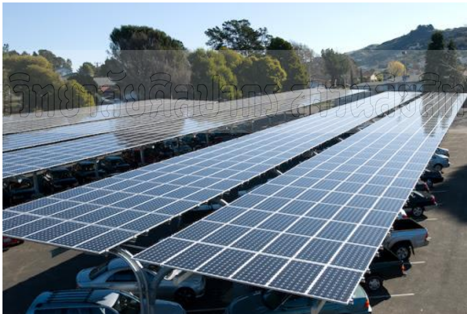
รูปที่ 11-4 การลดเกาะความร้อนซึ่งเกิดจากที่จอดรถขนาดใหญ่โดยทำหลังคาคลุม และติดตั้งแผงเซลล์แสงอาทิตย์ (ที่มา: http://www.monosun.net/ )
