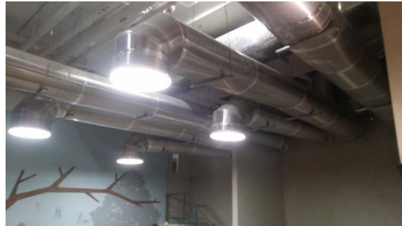
รูปที่ 10-38 ปลายท่อนำแสงในที่จอดรถใต้ดิน อาคาร สสส.
