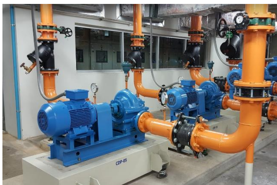
รูปที่ 9-11 Condenser Water Pump
