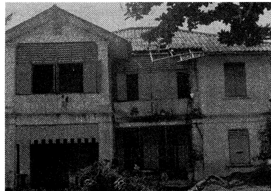
สภาพอาคารก่อนทำการซ่อมแซม
