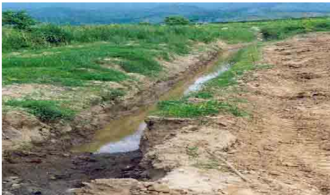
รูปที่ 5-3 การขาดทางน้ำเพื่อคักน้ำจากลำเหมืองสาธารณะ
