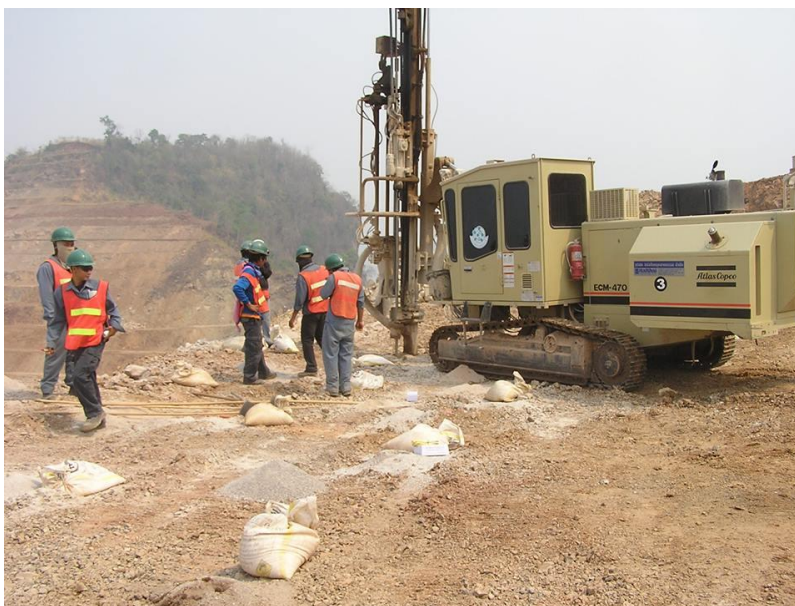
รูปที่ 6.4.3 คนขับรถเจาะผู้มีความสามารถในการขับรถเจาะหลบแก๊สไฟฟ้าและแทงดินระเบิด
