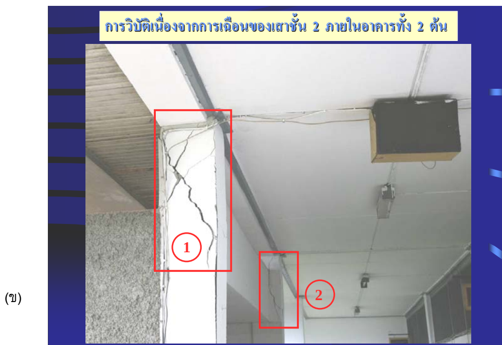
รูปที่ 7 (ก) อาคารโรงเรียนเมืงรามหาราชวิทยาคม เกิดความเสียหายจากแผ่นดินไหวลาว (ข) รอยร้าวทแยงในเสา
