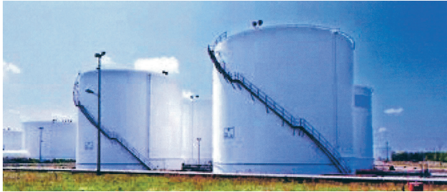
ถังบรรจุน้ำมัน Oil Product Tanks
