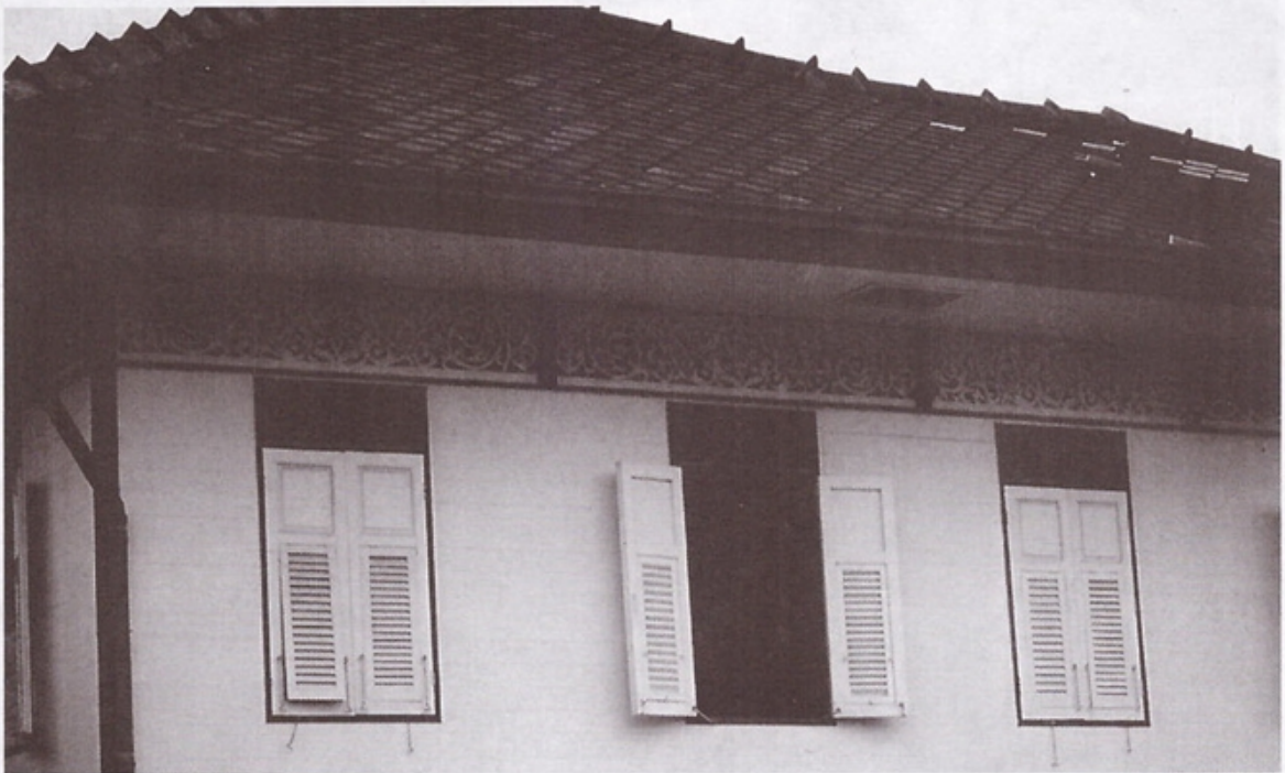
▲ ลวดลายแบบขนมปังขิงที่ติดตั้งบริเวณคอสอง
