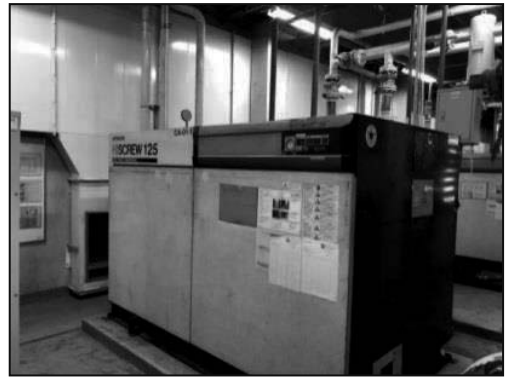
ภาพที่ 2 เครื่องอัดอากาศในระบบ
