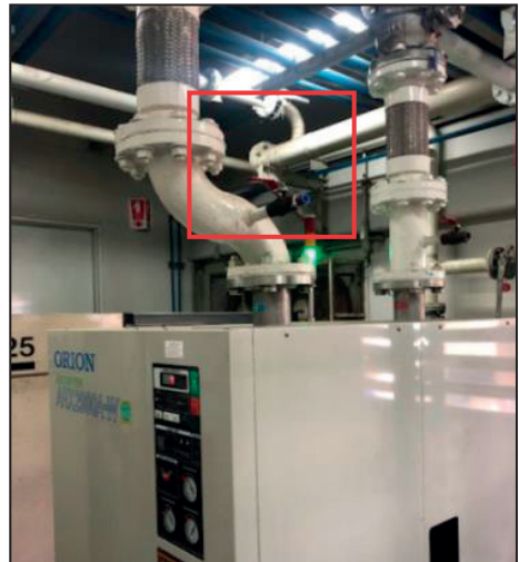
ภาพที่ 5 จุดที่ติดตั้ง Flow Meter
