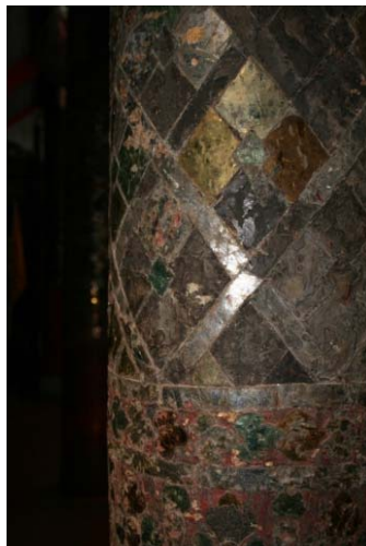
รูป ๒ - ๖๔ การประดับกระจกตะกั่วบริเวณเสาภายในวิหารและสภาพที่ชำรุด
