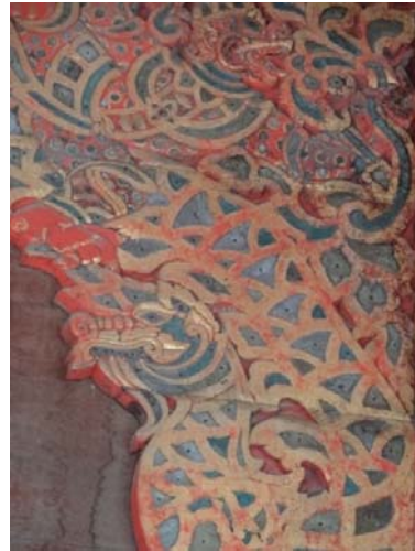
รูป ๒ - ๒๐ งานประดับกระจกที่โค้งคิ้ว แสดงให้เห็นถึงการต่อเติมมุขหน้าในภายหลัง
