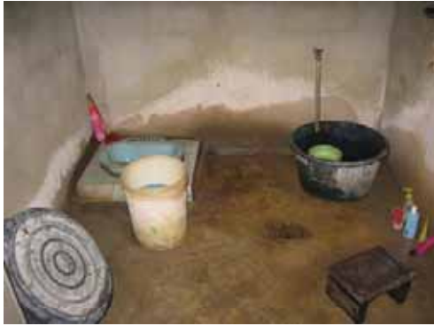
ลักษณะห้องน้ำที่ยังไม่มีความเหมาะสมในการใช้งาน
