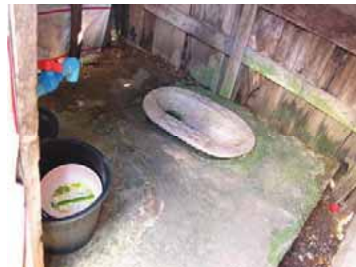
แสดงสภาพด้านในห้องน้ำที่ขาดสุขลักษณะ และไม่มีอุปกรณ์ราวจับพยุงตัว
